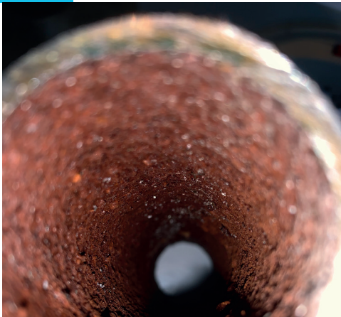
Bild 1: Korrosion ohne Silikatbe- handlung
