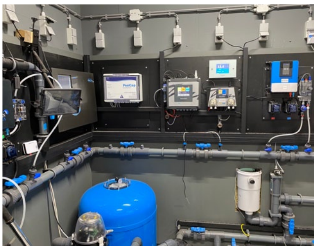
Frequenzgesteuerte Pumpen sparen Energie – und stellen dennoch die Hygiene sicher.
