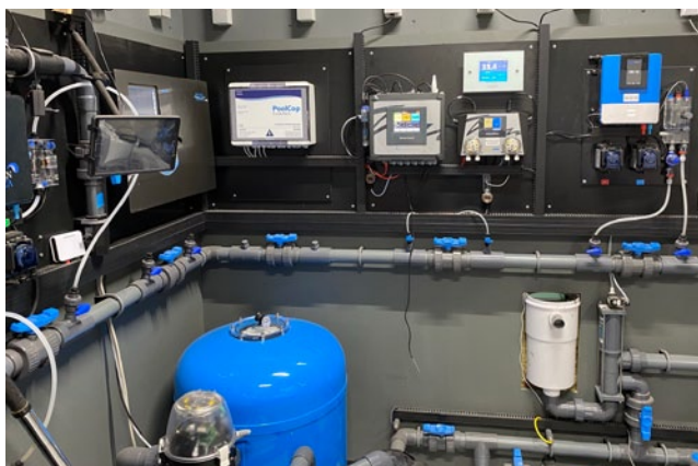
Les pompes à fréquence variable permettent d'économiser de l'énergie - tout en garantissant l'hygiène.
